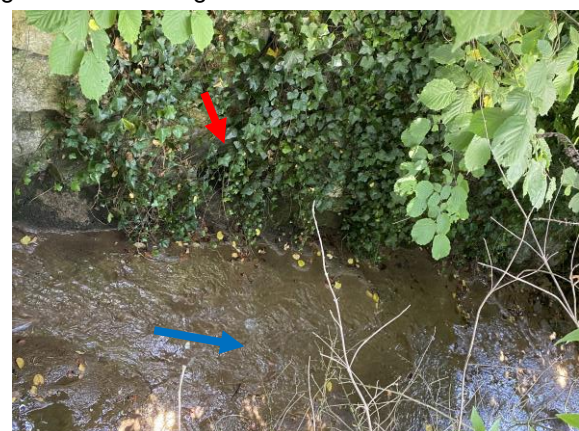
22: Einleitung von entlastetem Mischabwasser vom AVL-Kanal (Entlastung RA4). Blick von rechtsseitigem Ufer auf linksseitiges Ufer.
