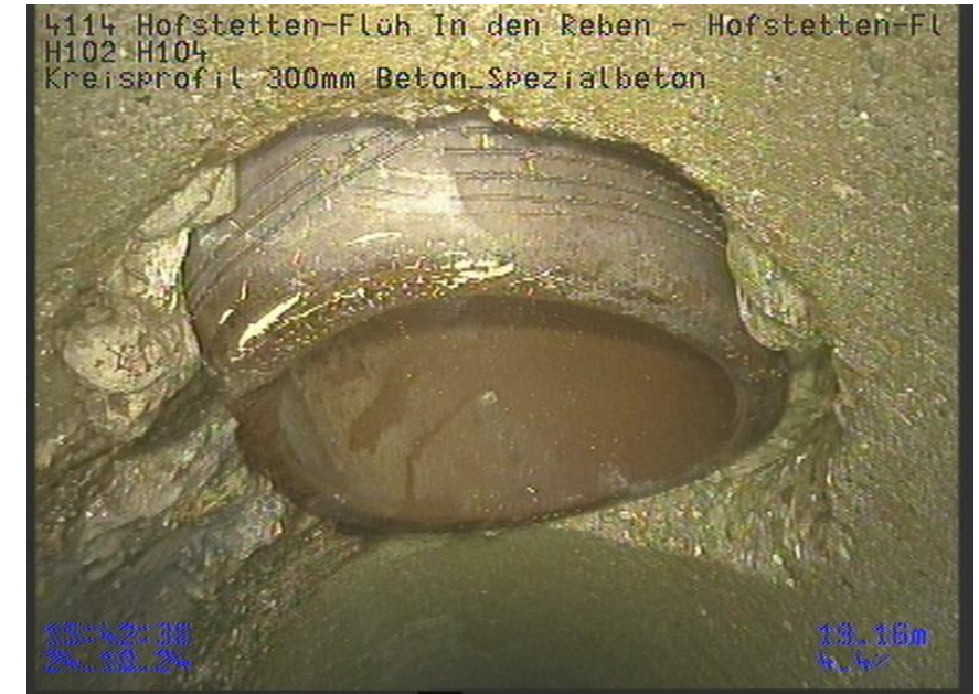
Beispiel Hausanschluss «In den Reben», Kanal-TV Untersuchungen Etappe 5
